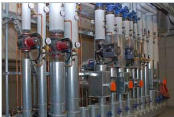
Hauptheizungsverteiler mit Grundfos-Hocheffizienzpumpen der Baureihen MAGNA und TPE (Bildnachweis: Grundfos)
