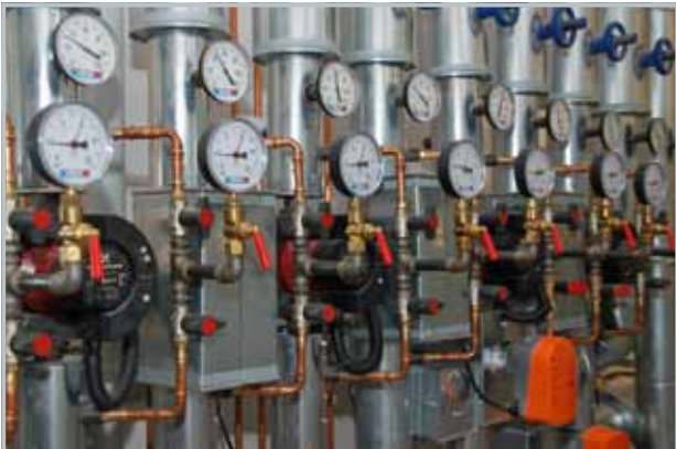
Heizungs-Unterverteilung im Bereich der Osttribüne mit MAGNA-Pumpen in Heizkreisen für Alemannia-Shop und Fankneipe (Bildnachweis: Grundfos)
