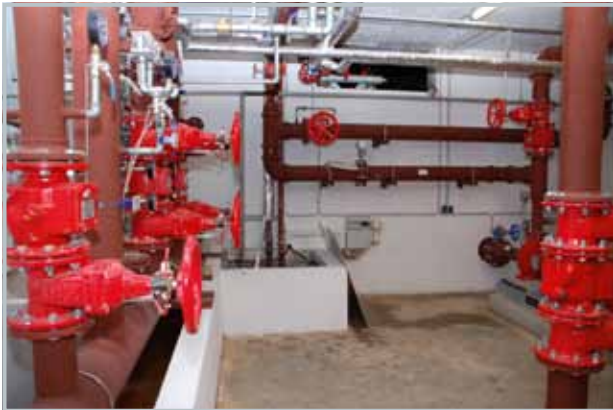
Sprinklerzentrale mit Pumpensumpf für die Entwässerung der Bodeneinläufe (Bildnachweis: Grundfos)
