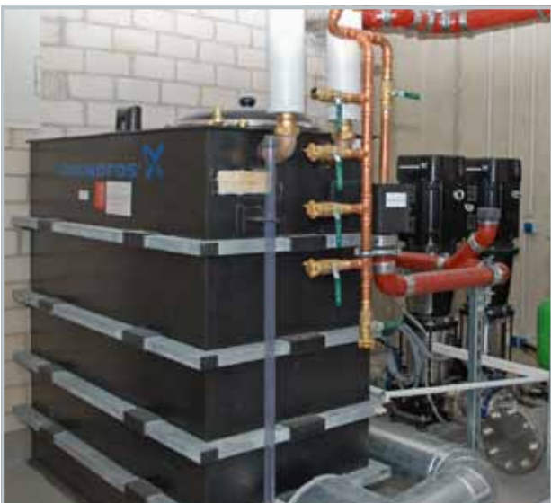
Druckerhöhungsanlage Grundfos Hydro MPC-S2CR90-3 mit 1.500-Liter-Vorlagebehälter für die Einspeisung von Überflurhydranten (Bildnachweis: Grundfos)
