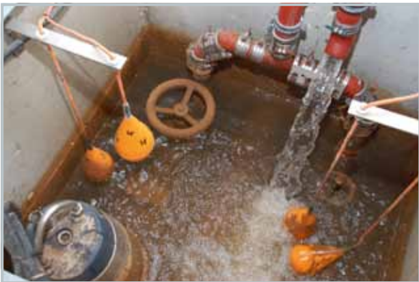
Pumpensumpf in der Sprinklerzentrale mit robusten Unilift AP-Tauchpumpen (Bildnachweis: Grundfos)
