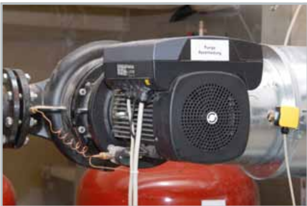
Warmwasser-Rasenheizungsanlage mit Grundfos-Pumpe TPE 80-120/2-S mit Differenzdrucksensor (Bildnachweis: Grundfos)
